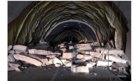
トンネル崩壊（国道249号）
