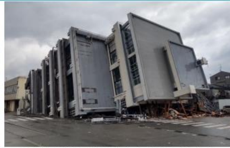
建物倒壊（輪島市河井町地内）
