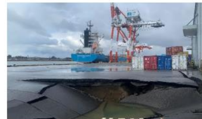
ふ頭用地陥没（金沢港（金沢市））
